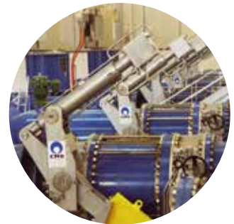
ESTACIONES DE BOMBEO
